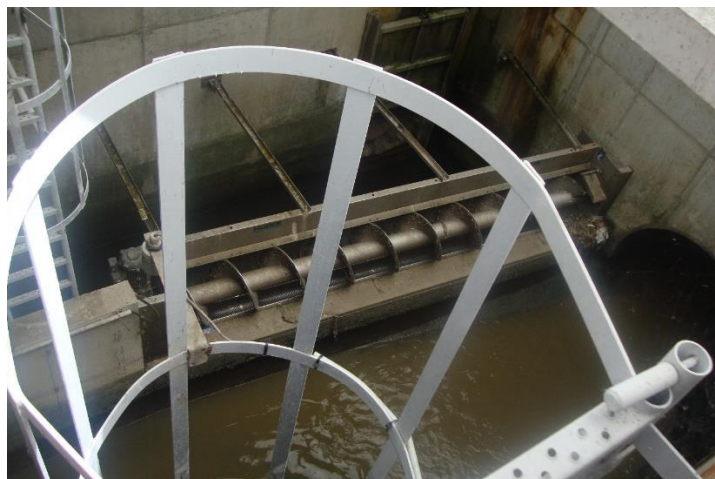
ФИГУРА 6-11: КАНАЛИЗАЦИОННА ПОМПЕНА СТАНЦИЯ № 1
