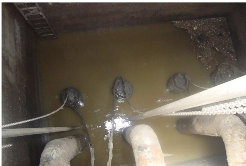
ФИГУРА 6-12: КАНАЛИЗАЦИОННА ПОМЕНА СТАНЦИЯ №2
